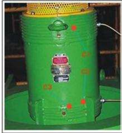
Obr. 1.2. Vyznačení měřících bodů na čerpadle
