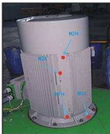
Obr. 1.1. Vyznačení měřících bodů na elektromotoru
